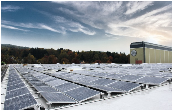
Bildunterschrift: 3.100 Quadratmeter Photovoltaikanlage befinden sich auf einem Hallendach im Werk Wiehl. (Quelle: BPW Bergische Achsen KG)
