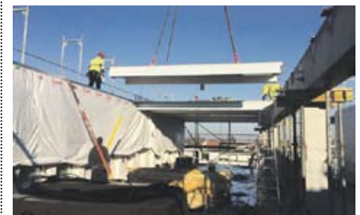
Deckenkonzept: Neben Stahlbeton als „Rückgrat“ in der Mitte kommen Holz-Beton-Verbunddecken in den Büros zum Einsatz.
