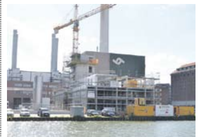
Das 31 mal 81 Meter große Areal ist umschlossen von der Hafenkäseerei Münster GmbH im Osten und dem Gelände der Cronos GmbH im Westen – im Norden liegt das Hafenbecken von Münster.
